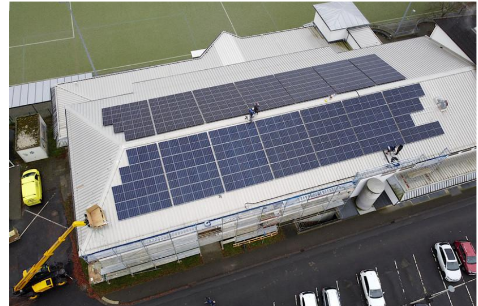
4 Dach-PVA Bürgersonnenkraftwerke Installierte Leistung: ca. 236 kWp Ø-Jahresertrag: ca. 236 MWh
