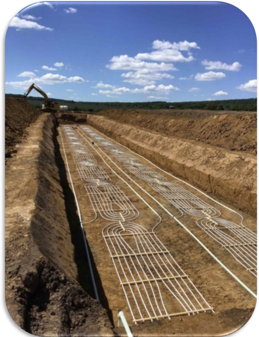
Teilfläche Kollektor Bad Nauheim
